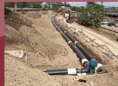
■ ŐRMEZŐ, DISTRICT HEATING, 2013
