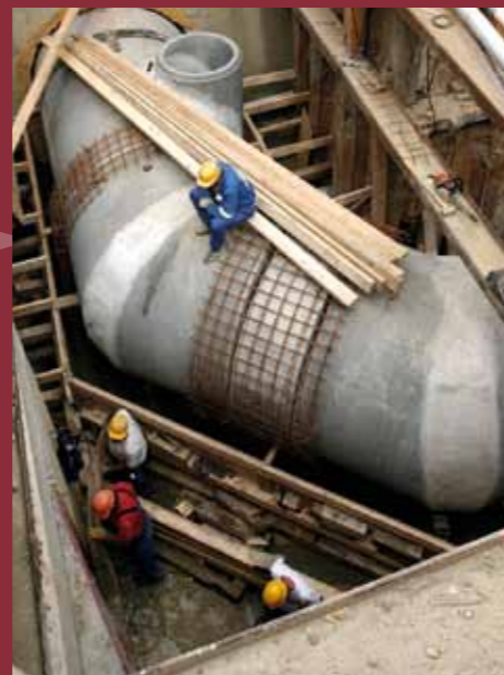
■ ПЭШТЕРЖЭБЭТ, ОБХОДНАЯ СТОКОВАЯ КАНАЛИЗАЦИОННАЯ ТРУБА, 2012
